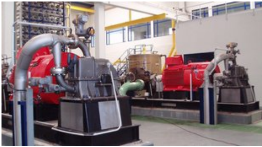
Imatge d'arxiu de part de les instal·lacions de la dessalinitzadora de la Tordera. Foto: JORDI PRADES.
