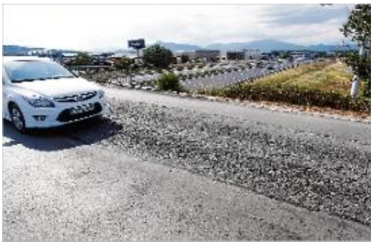
El Camí dels Carlins és una carretera que es troba molt malmesa.
