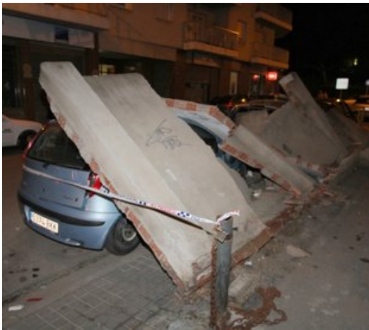
La caiguda del mur va afectar tres vehicles. Foto: AJUNTAMENT DE BLANES.
