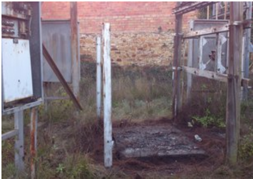
L'estació elèctrica t' tres torres i els lladres van desmuntar una estructura Foto: AJ. BLANES.
