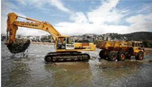
El moviment de la sorra afecta el front de mar rosinc.
