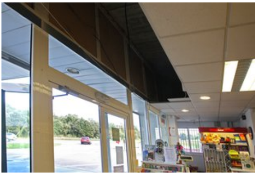
D'entre les destrosses que van causar, van fer caure unes plaques del sostre Foto: LLU S SERRAT.
