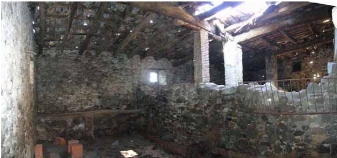
Foto 38: Coberta en mal estat zona Oest
