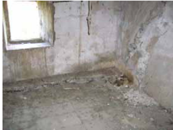
Foto 23: Forjat enfonsat de planta segona.
