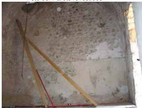
Foto 54: Revestiment de parets caigut
