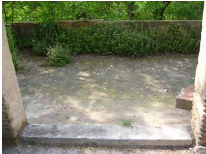
Foto 42: Entrada d'aigua per balcó de l'habitació H.26
