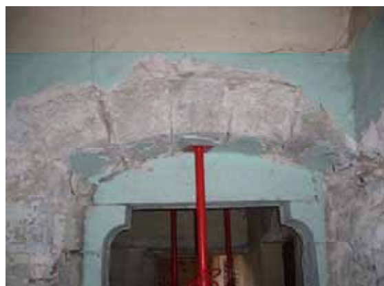
Foto 59: Arc a dovella apuntalat
