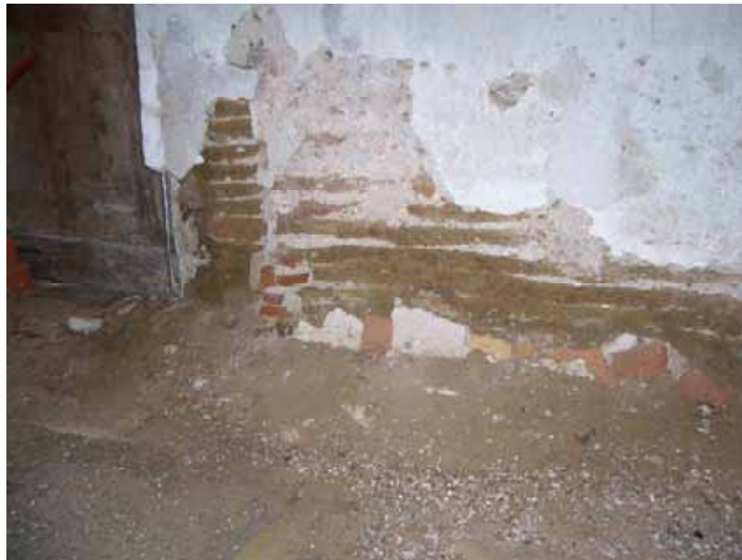
Disgregació del material del parament
