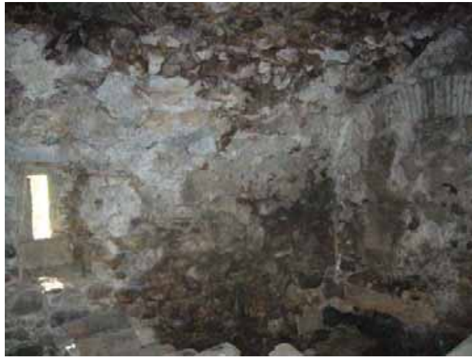
Foto 41: Entrada d'aigua en l'estança inferior de la terrassa.
