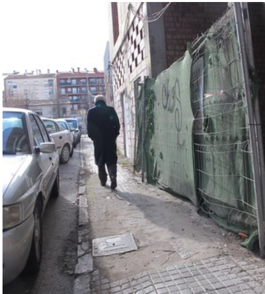
Una de les voreres malmeses en aquest cas al carrer Manuel de Falla Foto: J.N.
