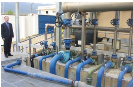
Instal·lacions d'Aigües de Banyoles, l'empresa que capta l'aigua de l'estany. Foto: R. E.
