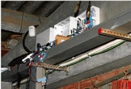
Els lladres van destrossar els cables de l'alarma però va sonar.
