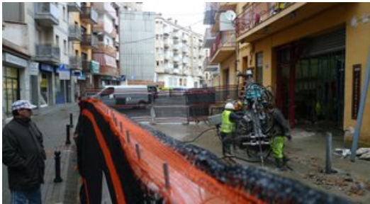
La Rambla Joaquim Ruyra tallada al trànsit, just al davant de l'edifici que es va haver de desallotjar, el 2011. Foto: N. FORNS.
