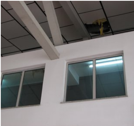
Un dels forats que els lladres van fer al sostre de la ITV de Palamós. Foto: SCAR PINILLA.
