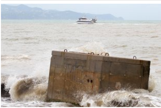
Un dels pous de formigó de la platja de s'Abanell de Blanes, ahir al migdia Foto: J. RIBOT / ICONNA.
