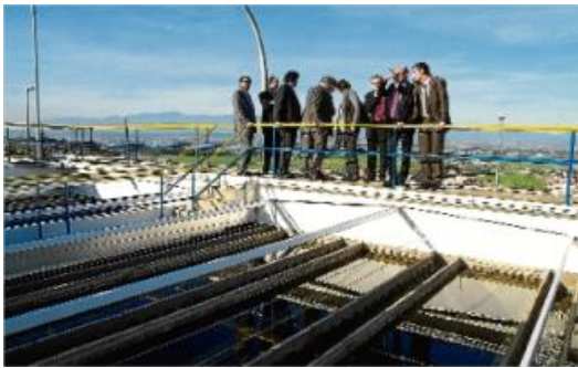
Les instal·lacions de l'estació depuradora de Figueres el 2009.
