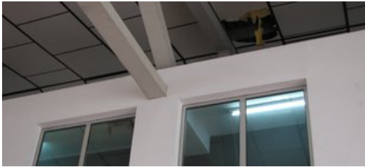
Els dos forats que van fer els lladres al sostre de les oficines i de la nau a l'ITV de Palamós a l'agost passat Foto: Ò. PINILLA.
