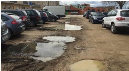
L'alta densitat de cotxes malmet molt l'espai de l'aparcament. S'espera que l'asfaltatge acabi amb aquest problema Foto: J.N.
