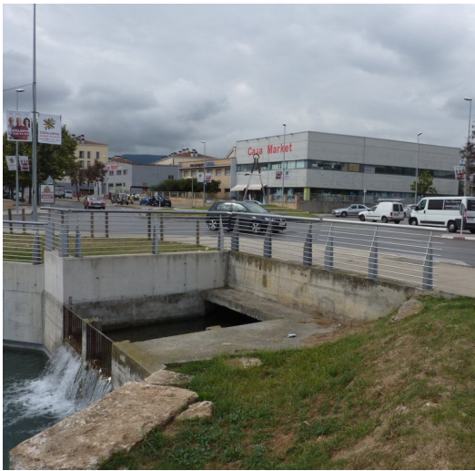
L'avinguda de la Farga, en el tram que sol inundar-se quan hi ha pluges sobtades. Foto: R. E.
