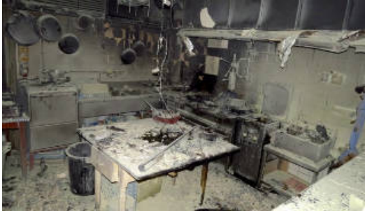
Un foc destrueix la cuina del teatre de Blanes
