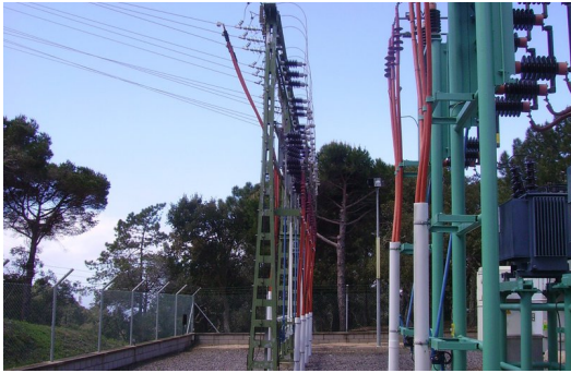
La subestació d'Endesa a Lloret de Mar, que ha estat objecte de millores per part de la companyia. Foto: EL PUNT AVUI.
