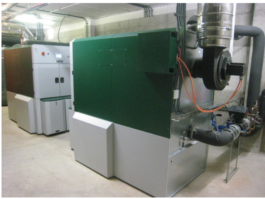
Les dues calderes de biomassa, en el soterrani de la piscina
