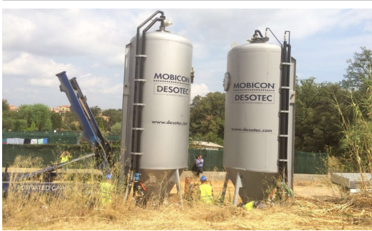
Els dos filtres de carbó actiu instal·lats al dipòsit de subministrament d'aigua de la Bisbal i Forallac Foto: ACN.
