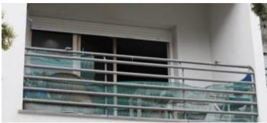
El balcó del pis incendiat a l'avinguda Ferran Agulló de Tossa de Mar.
