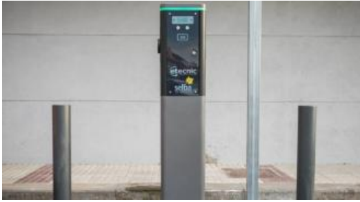
Santa Coloma instal·la una estació de càrrega de vehicles elèctrics
