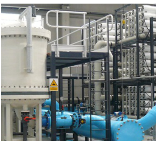
Interior d'una estació regeneradora d'aigua ACA.
