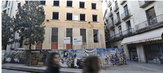
La Central del Molí, unes obres pendents que les inversions preveuen desencallar.
