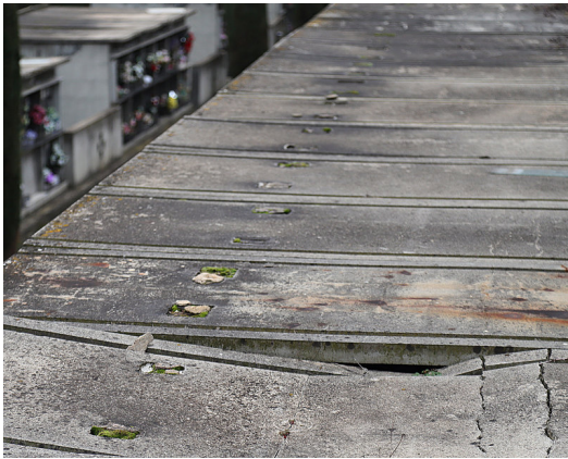
El sostre dels nínxols de dalt de tot del cementiri nou, amb esquerdes, ahir. MANEL LLADÓ.
