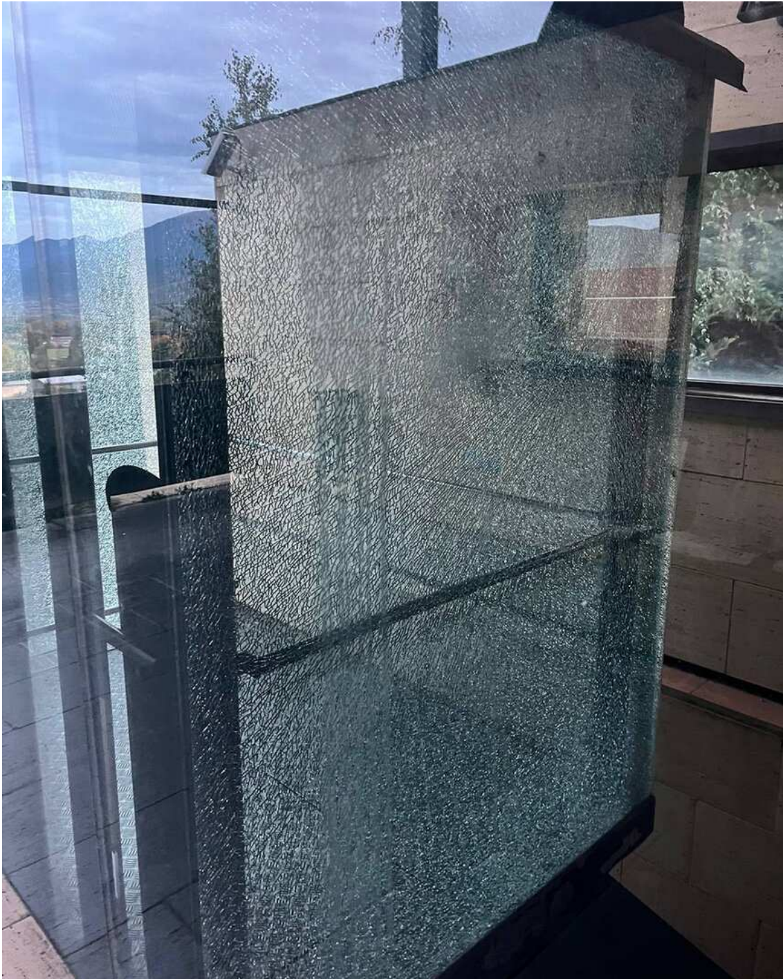
Vidres destrossats del funicular de Puigcerdà que connecta el Barri de l'Estació amb el Raval de les Monges / puigcerda.cat
