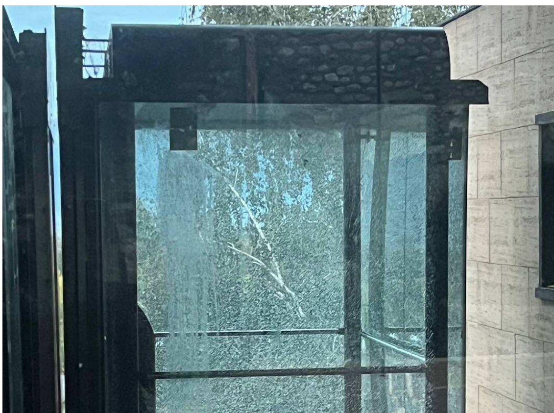
Vidres destrossats del funicular de Puigcerdà que connecta el Barri de l'Estació amb el Raval de les Monges / puigcerda.cat
