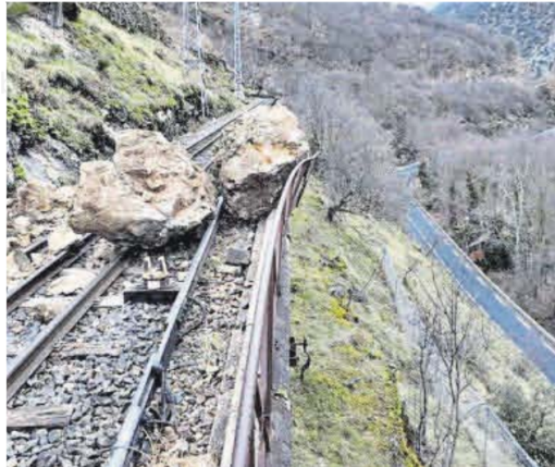
Roques sobre la via de l'eix viari RD66
