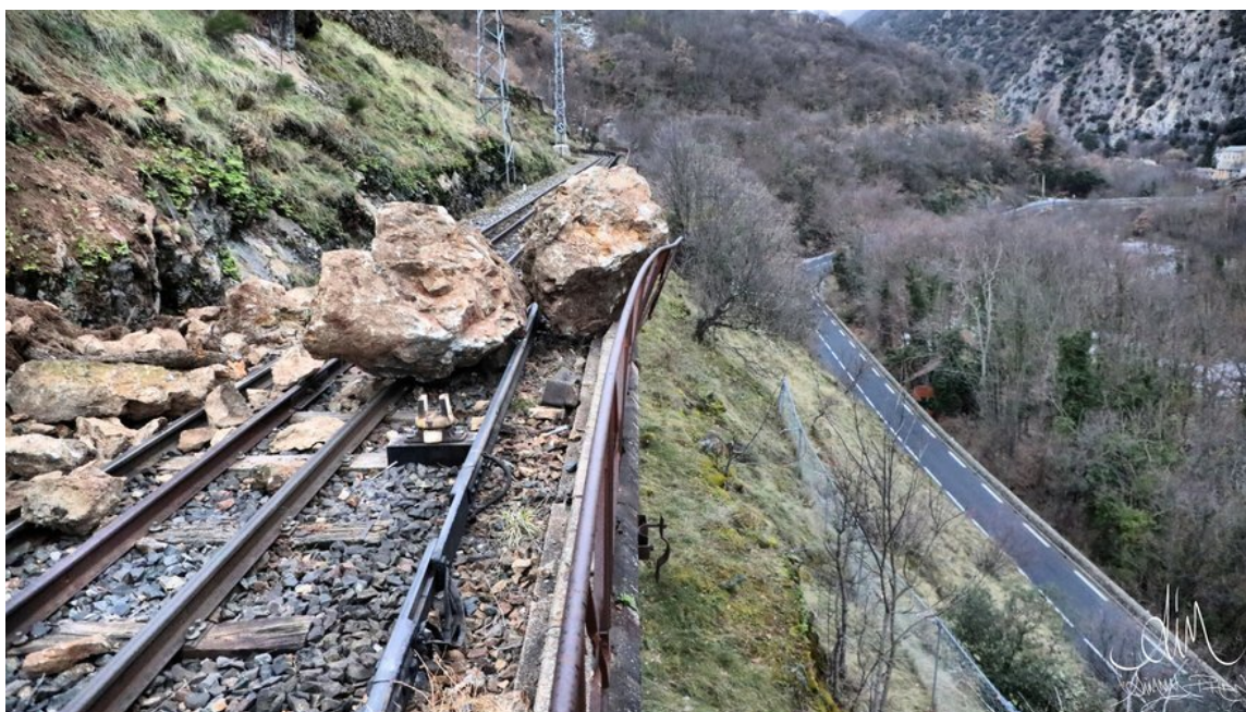
Els blocs de pedra caiguts a la via fèrria amenacen la RD66 a la part inferior / Jimmy Phan - L'Indépendant
