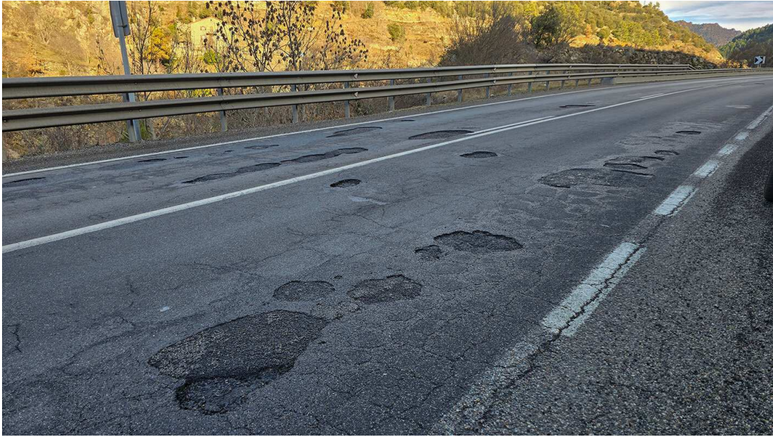
Tram de la carretera estatal i la degradació actual / J.P.V.
