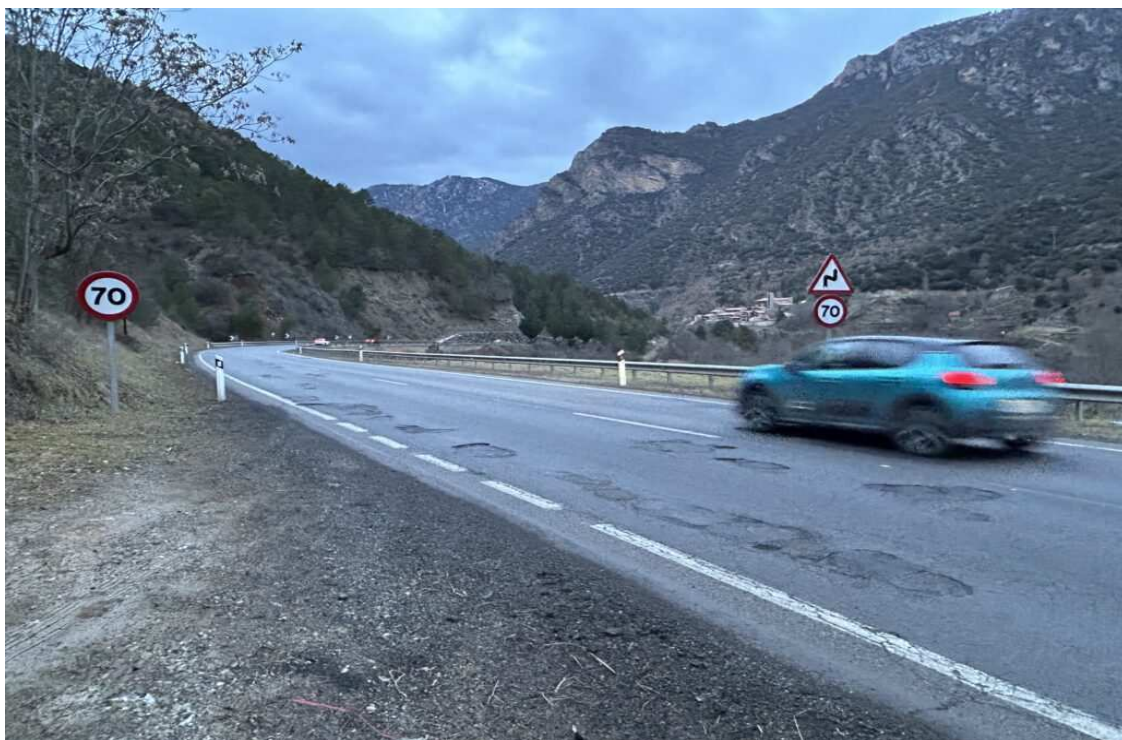
Estat de l'N-260 al Pont de Bar. / M.B.F.
