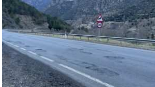
Estat de l'N-260 al Pont de Bar. / M.B.F.
