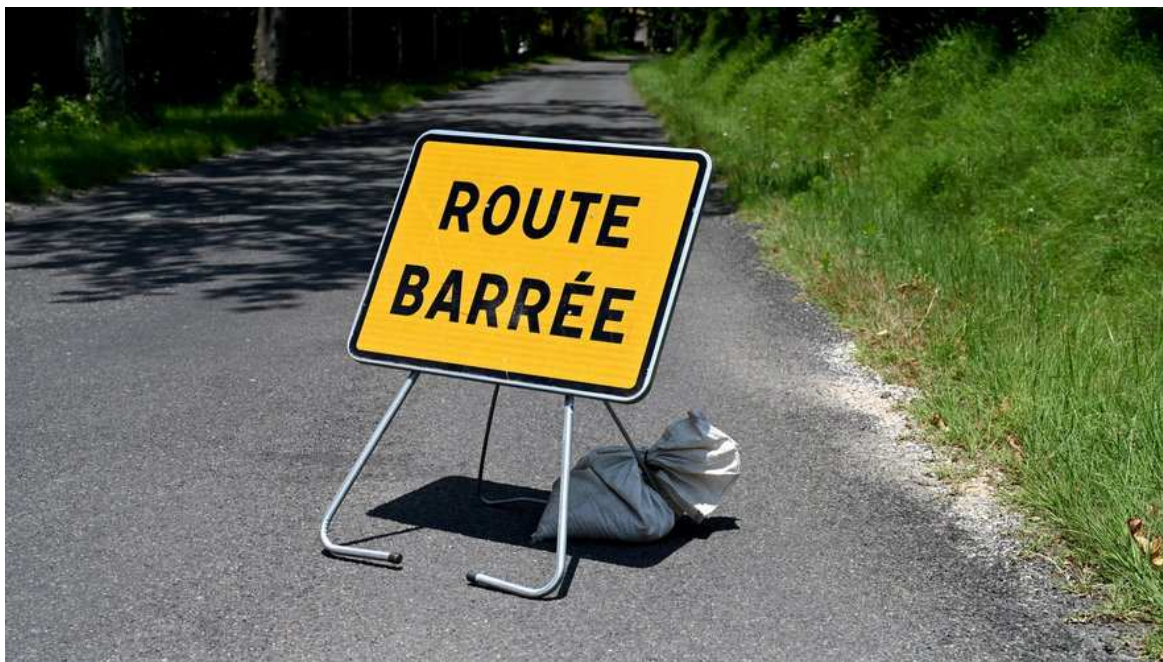
La route départementale 66 a été fermée en urgence ce vendredi 6 mars 2026. L'Indépendant - BOYER Claude
