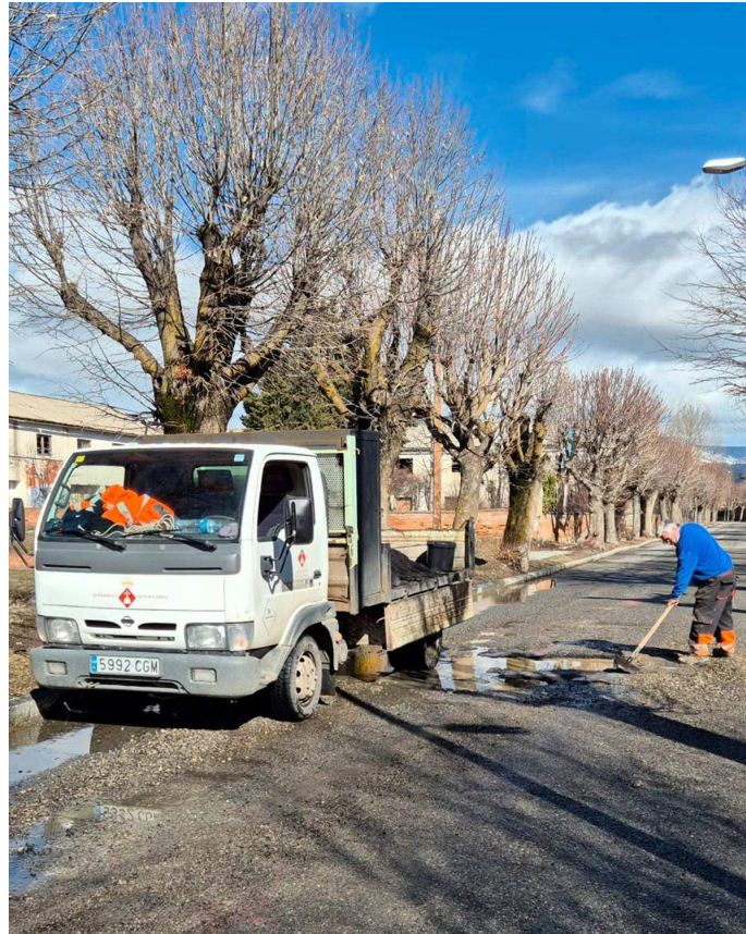
Feines de millora dels carrers amb més forats / AJ PUIGCERDÀ
