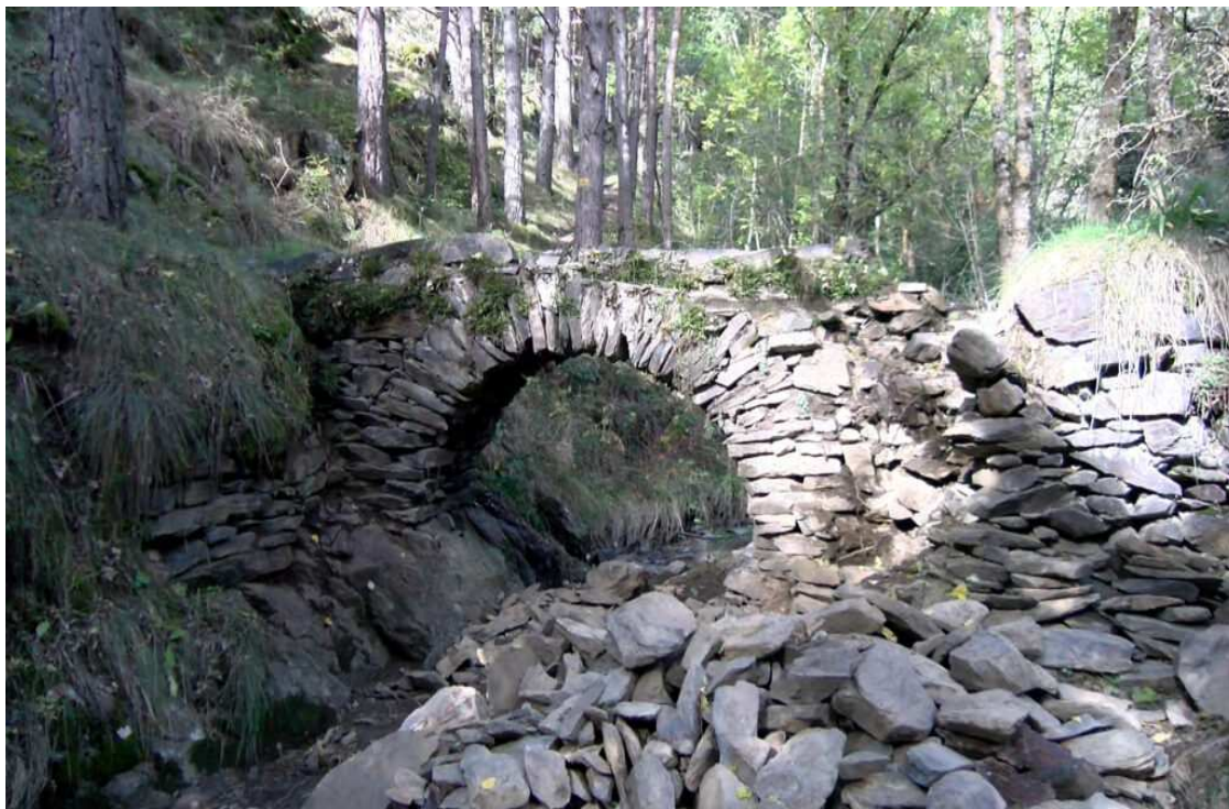
Estat actual del pont del Carrassut / M.F.C.
